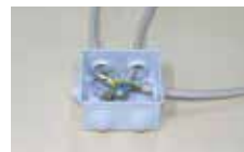
Cablee dentro de la caja de conexiones
